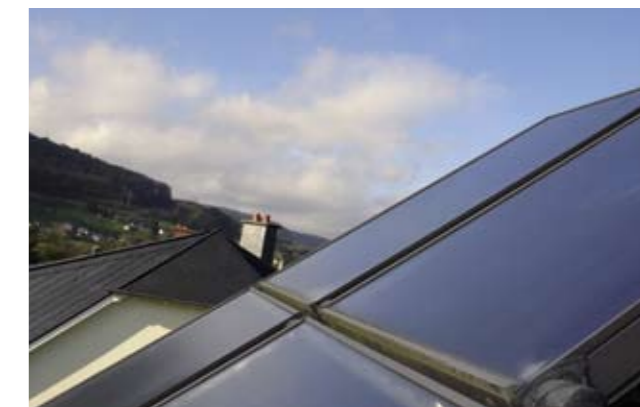
Installation solaire thermique
